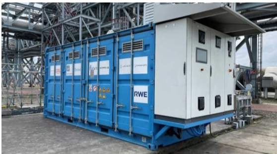
Figuur 6. Battolyser pilot op RWE in Eemshaven
